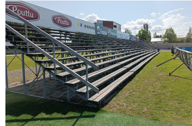
Kuvassa näkyvä Keskusurheilukentän irtokatsomo on poistettu huonon kunnon vuoksi kokonaan, jolloin käyttöön jää ainoastaan vanha pääkatsomo.
